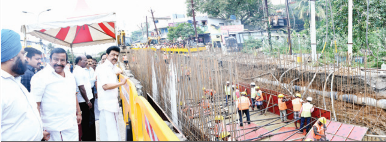
● முதல்வர் மு.க.ஸ்டாலின் நேற்று தீர்வுவகுத்துறை சார்பில் பள்ளிக்காரணை தாமரைக்குளம் அருகில், பள்ளிக்காரணை அணை ஏரியிலிருந்து வெளியேறும் வெள்ள நீரினை பள்ளிக்காரணை சதுப்பு நிலத்திற்கு கொண்டு செல்ல ஏதுவாக ரூ.57.70 கோடி மதிப்பீட்டில் பள்ளிக்காரணை அணை ஏரியிலிருந்து சதுப்பு நிலம் வரையில் முடிய பெரு வடிகால்வாய் அமைக்கும் பணிகளை பார்வையிட்டு ஆய்வு செய்தார். இந்நிகழ்வின் போது அமைச்சர்கள் கே.என்.நேரு, க.பொன்முடி, மா.சுப்பிரமணியன், நாடாளுமன்ற, சட்டமன்ற உறுப்பினர்கள் மற்றும் அரசு உயர் அலுவலர்கள் உடனிருந்தனர்.
